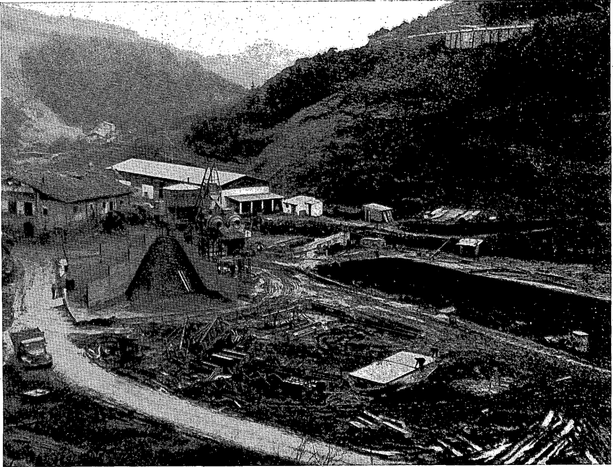
Fig. 9. — Presa de Undurruga. Excavación del aliviadero. (Undurruga dam. Excavation of the spillway.)
