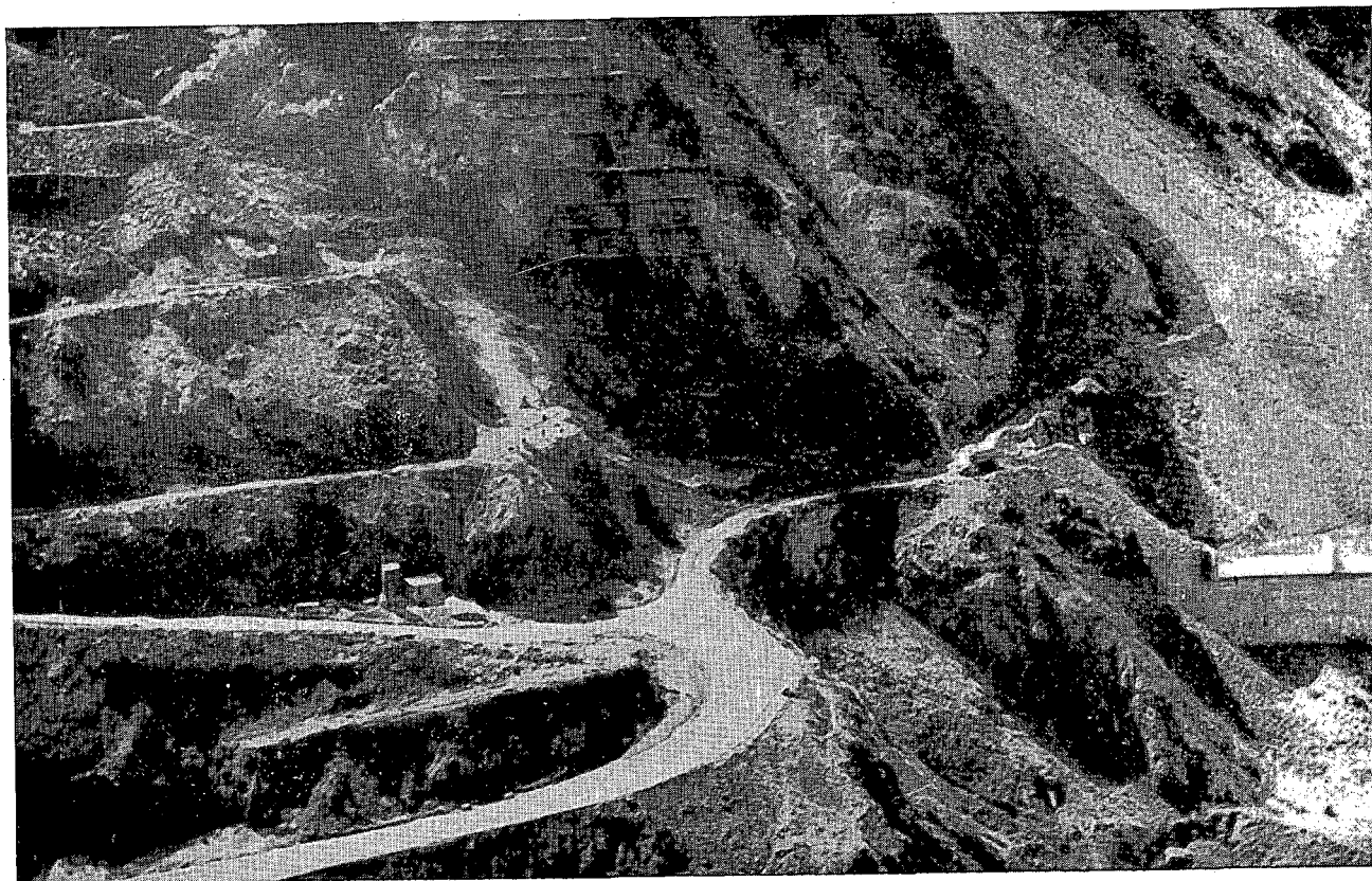
Fig. 4. — Vista general de la margen derecha de la presa El Atazar. Fotografía hecha en marzo de 1968, mostrando la excavación.
