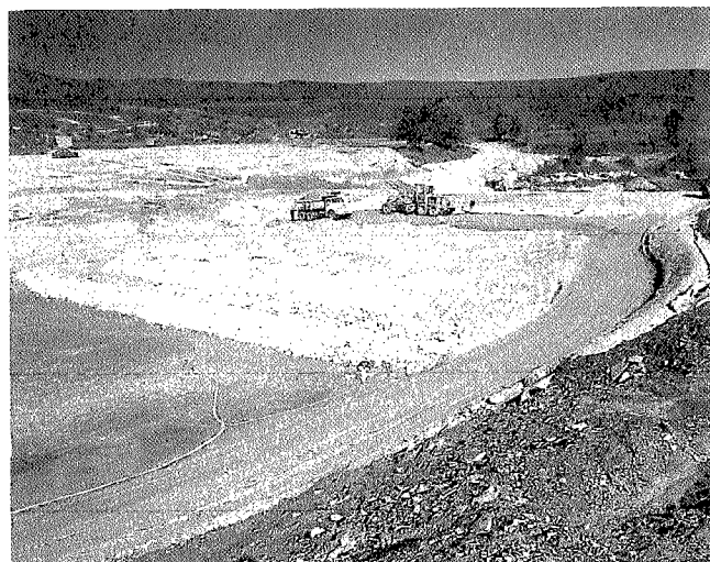
Figura 7. — Construcción del tapiz de arcilla, enlace del mismo con el núcleo de presa y arranque del espaldón de grava.
