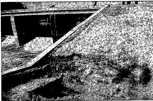
Erosión al pie de la presa.
