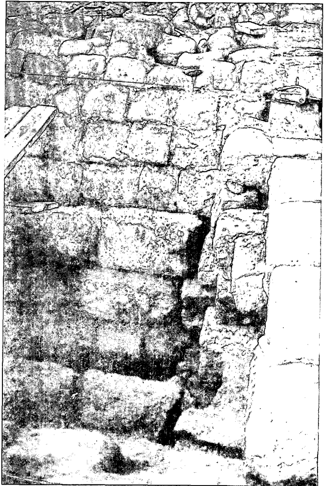
Figura 6. Trassos de la bóveda y el tímpano de Ponte Freixo durante su restauración.
