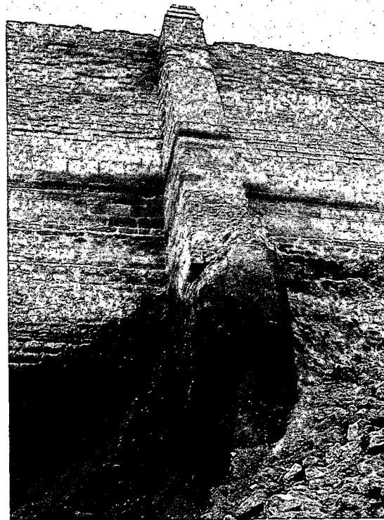
Figura 7. Detalle de un contrafuerte donde se observan los dos tipos de fábrica
