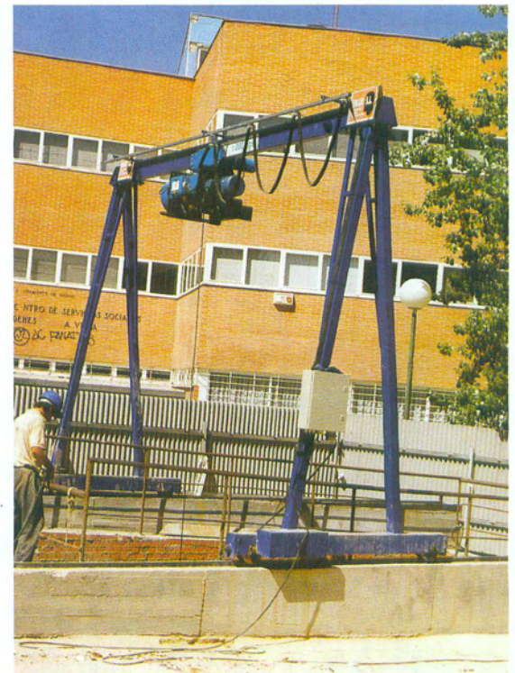
Pozo de ventilación. Metro Línea 7. Tramo 3.
