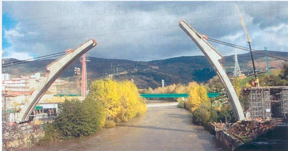
Fig.1. Los semiarcos del Puente 1 sobre el río Nervión durante el proceso de abatimiento.
