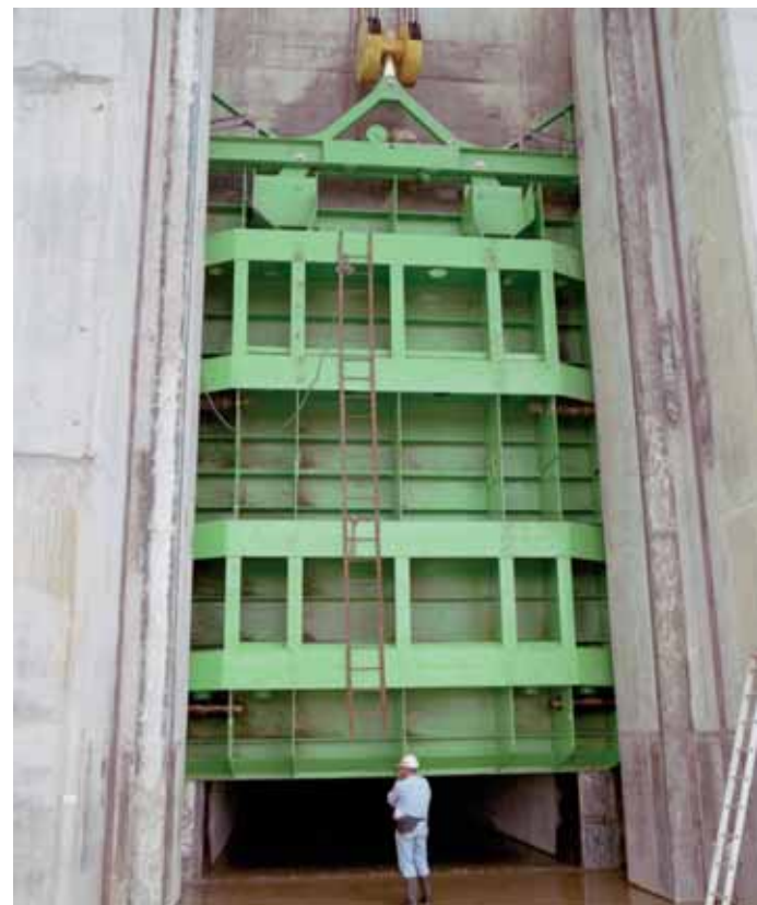
Compuerta de cierre del desvío
