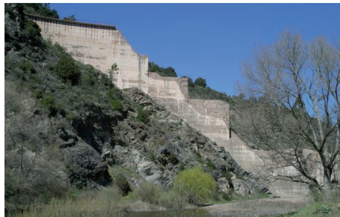
Fotografía Nº 7.- Restos de la bóveda de Malpasset, tras su rotura el 2-Diciembre-1959.
