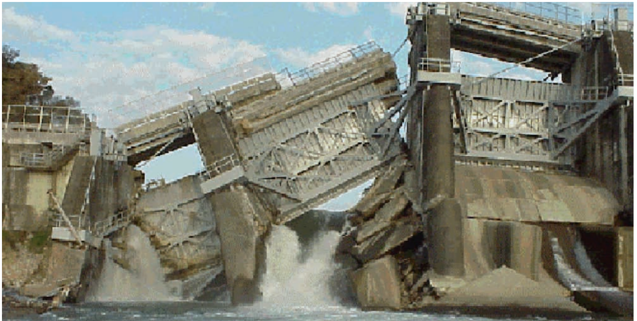
Fotografía N° 11.- Presa vertedero de Shi-Kang (Taiwan) tras el terremoto de Chi-Chi (21-Septiembre-1999). Se localizaba en una falla activa que experimentó un "salto vertical" de hasta 7.7 m.
