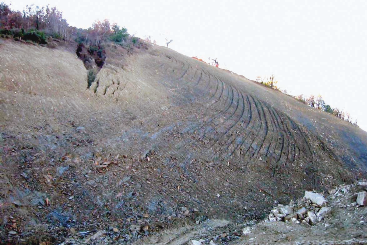
Fig. 16. Rotura por toppling en las excavaciones del estribo izquierdo.
