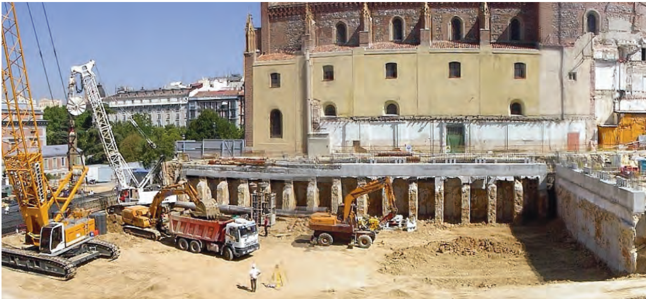
Vista general tras la ejecución de la pantalla contigua a la iglesia.
