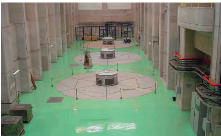
Interior de la Central/Interior da Central.
