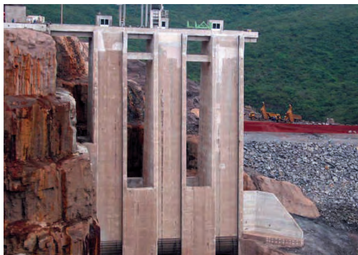
Torres de la Toma de Agua/ Torres da Tomada de Água.
