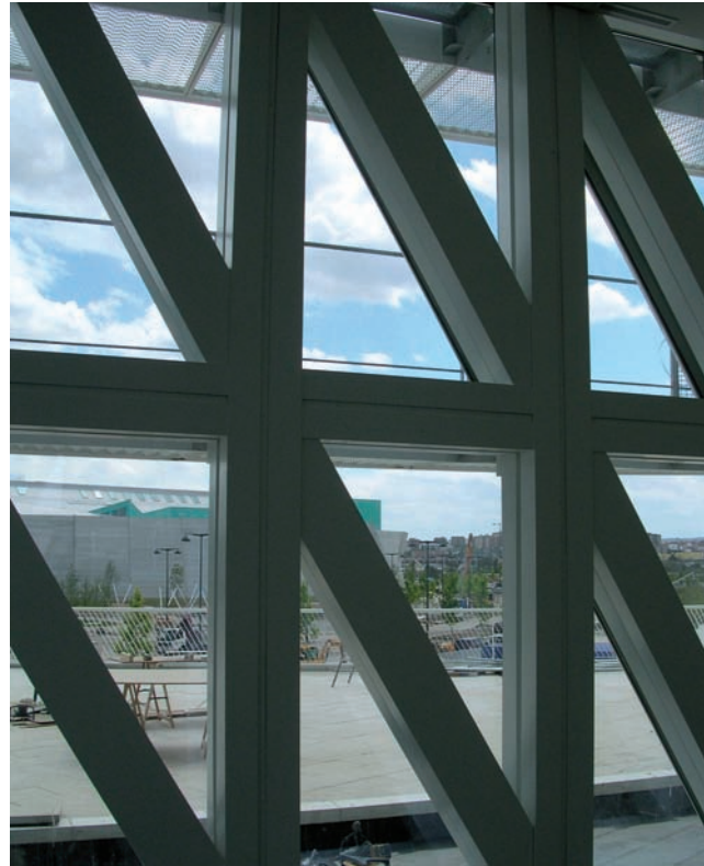
Fig. 9. Aplicación de la protección ignífuga de la fachada y vista final una vez colocado el revestimiento de aluminio.
