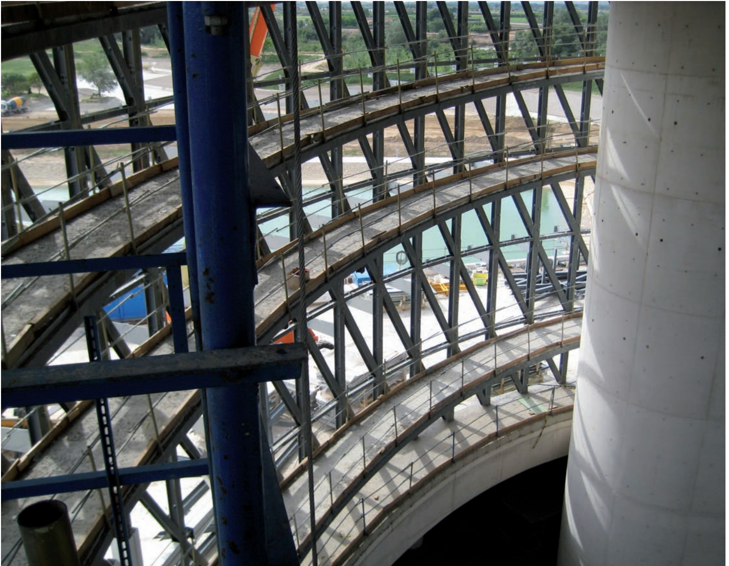
Fig. 7. Tramos interiores de la estructura de fachada con doble longitud de pandeo a causa de la eliminación de una de las rampas.
