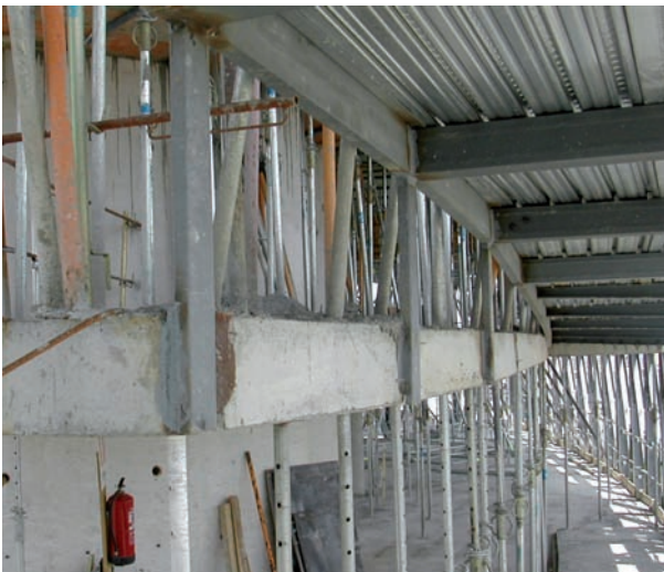
Fig. 8. Apoyo elástico de los forjados de descansillo en la fachada a través de las vigas metálicas de la rampa.
