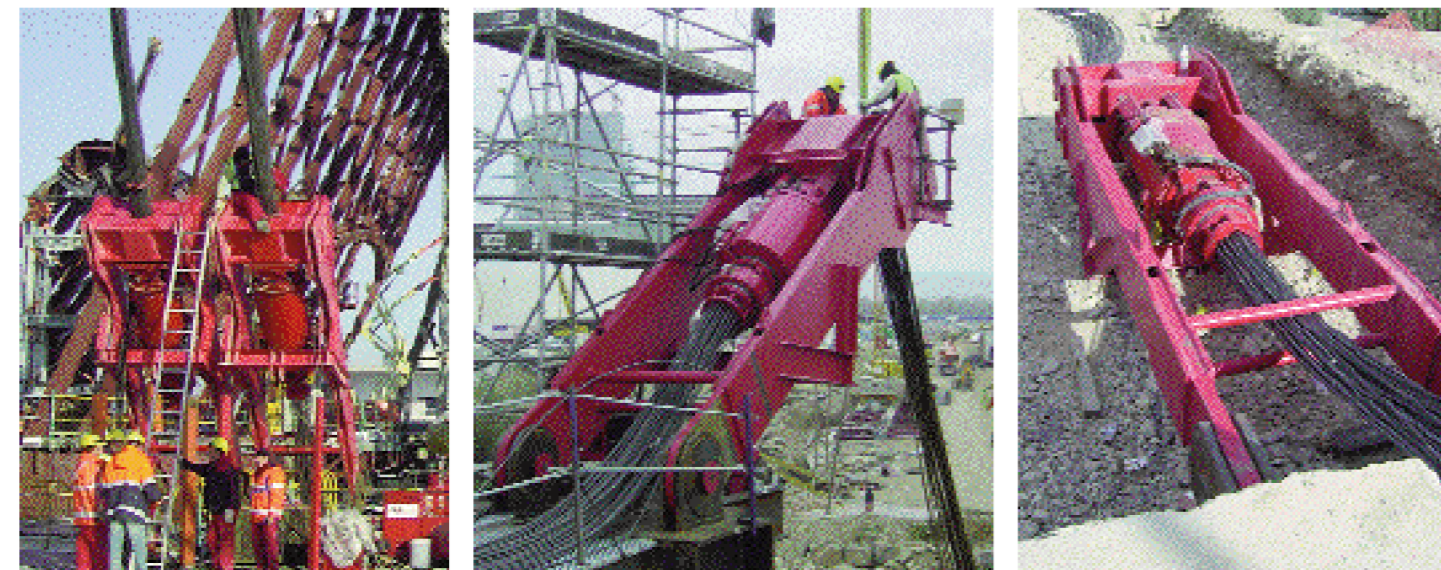
Fig. 12. Unidades de control de los cables. a) Cables de retenida de la torre. b) cables de tiro. c) cables de retenida del puente.
