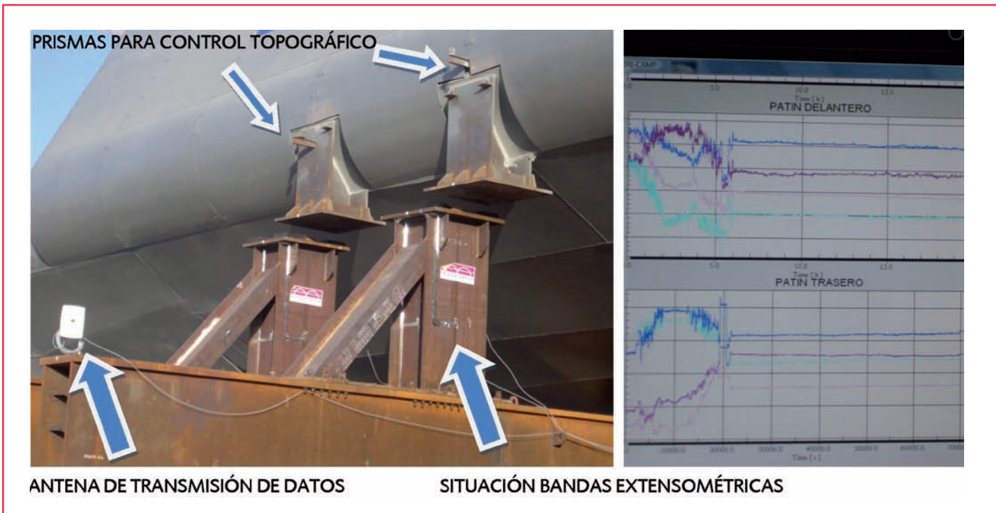
Fig. 20. Sensores instalados en los elementos de sujeción del puente y resultados recibidos en un ordenador de los esfuerzos en las patas durante una etapa del proceso.
