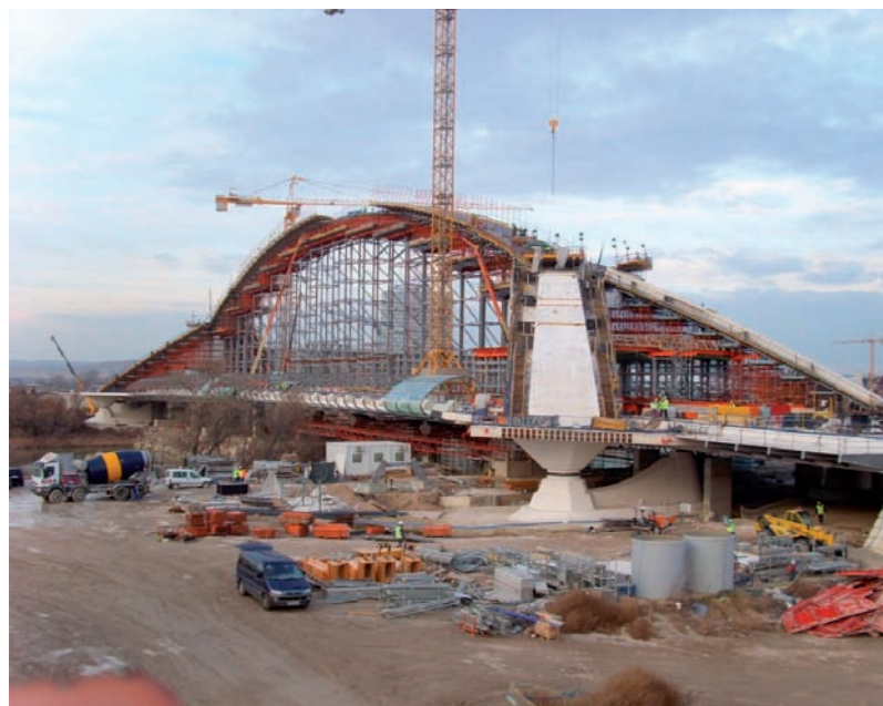
Foto 19: Vista general de la cimbra de arco formada por torres en la zona central y cimbra cuajada en pies inclinados
