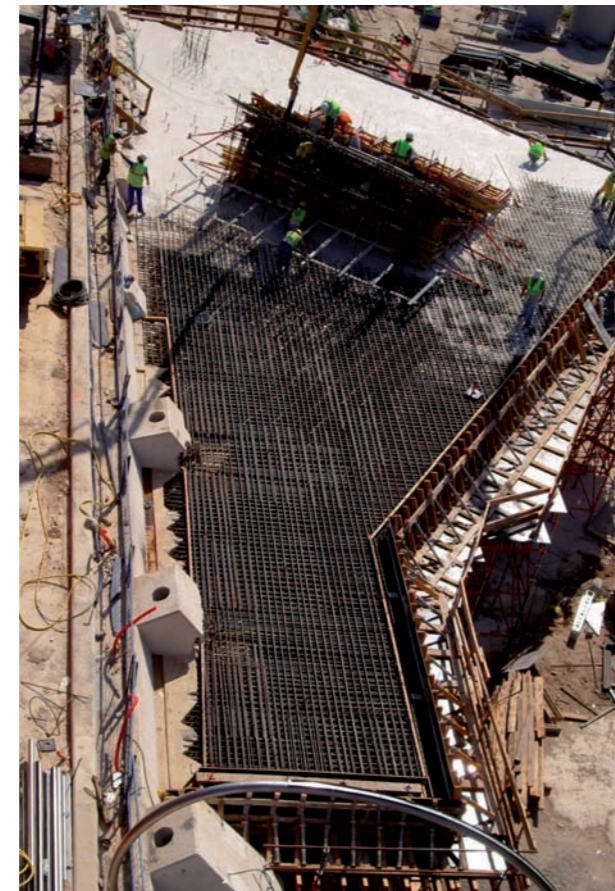
Foto 12: Hormigonado por bombeo de una laja de amarre con varias capas de armadura y pretensado en dos direcciones
