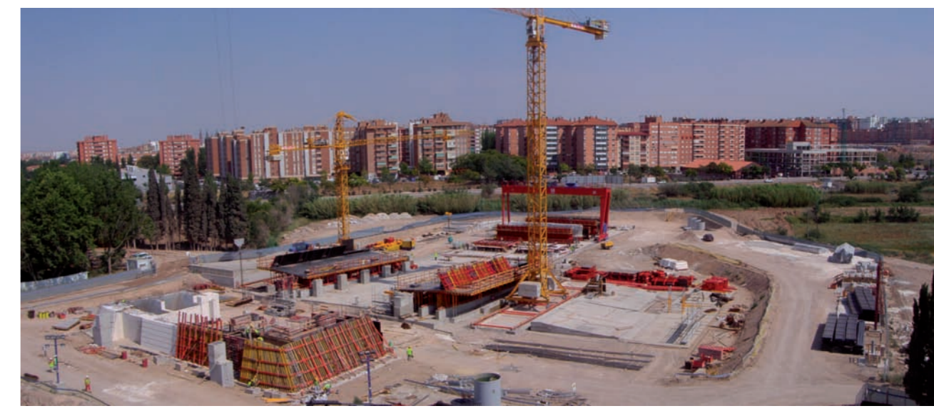
Foto 13: Vista general de la zona de construcción de margen derecha. De primer a último plano están el estribo, el encofrado de las dovelas con sus áreas de trabajo laterales y el parque de fabricación de prelosas y, por último, la zona de prefabricación de diafragmas, justo bajo el pórtico grúa.
