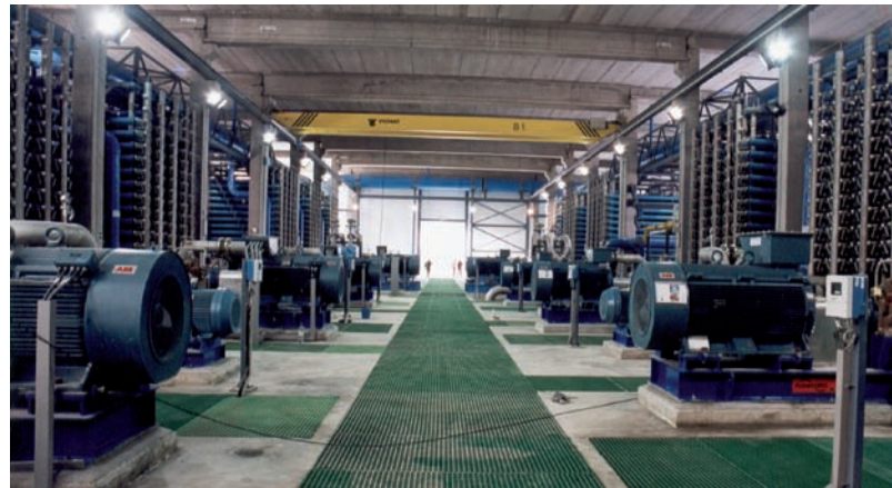
Fig. 4. Desalobrador de El Atabal. Edificio de ósmosis.
