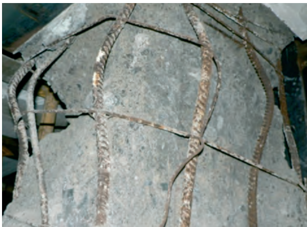
Fig. 11. Soporte de hormigón perteneciente a una estructura de edificación que exhibía, treinta años después del final de su construcción, graves vicios ocultos de proyecto y de construcción así como importantes pérdidas de durabilidad (foto de los autores).
