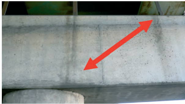
Fig. 8. Fisura diagonal que evidencia la movilización de una biela comprimida (fotos de los autores).
