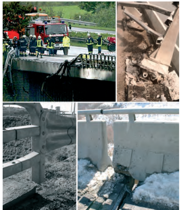
Fig. 18. Pretiles: un ejemplo de elemento vinculado a la seguridad del usuario y que tiene implicaciones estructurales y de mantenimiento (las fotos inferiores son de los autores).
