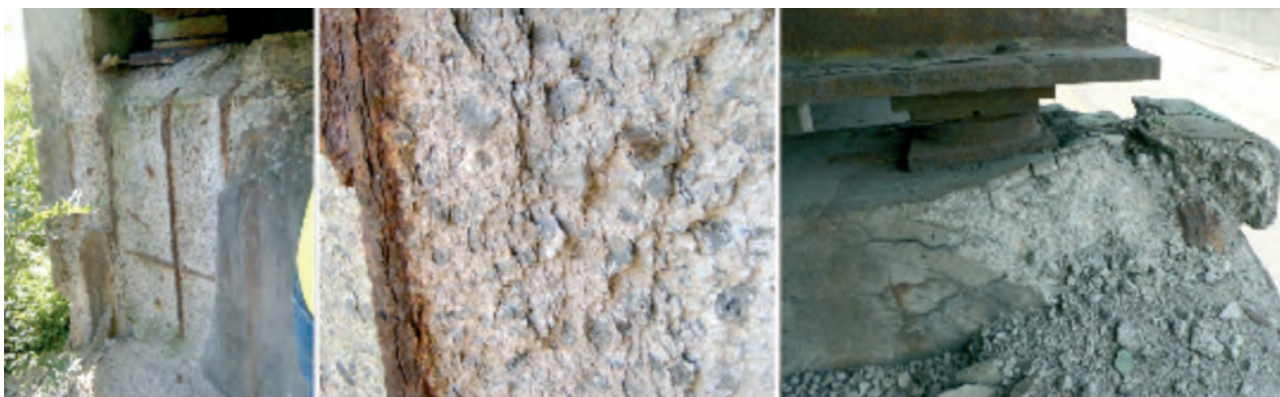
Fig.12. Efecto de las sales de deshielo. Está fuertemente arraigada la idea de que sales=cloruros=corrosión de las armaduras, pero resulta aún peor, en condiciones climáticas extremas, la acción expansiva de las sales al cristalizar cuando se evapora el agua en que estaban disueltas (fotos de los autores).
