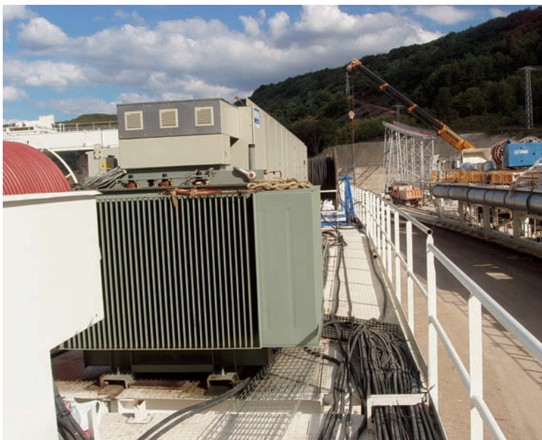
Fig. 7. Transformador auxiliar instalado en el back-up.
