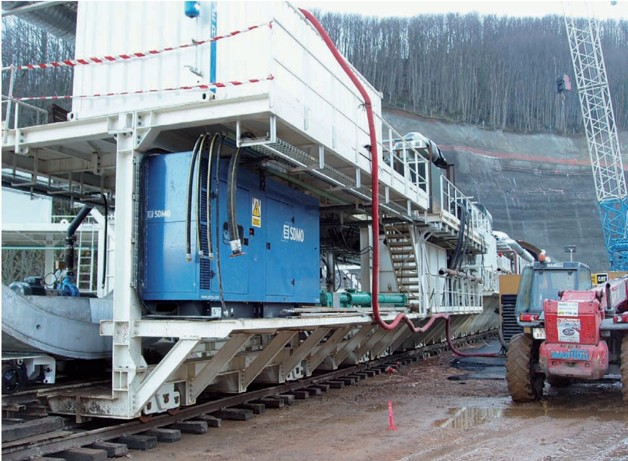
Fig. 8. Grupo electrógeno de emergencia instalado en el back-up.
