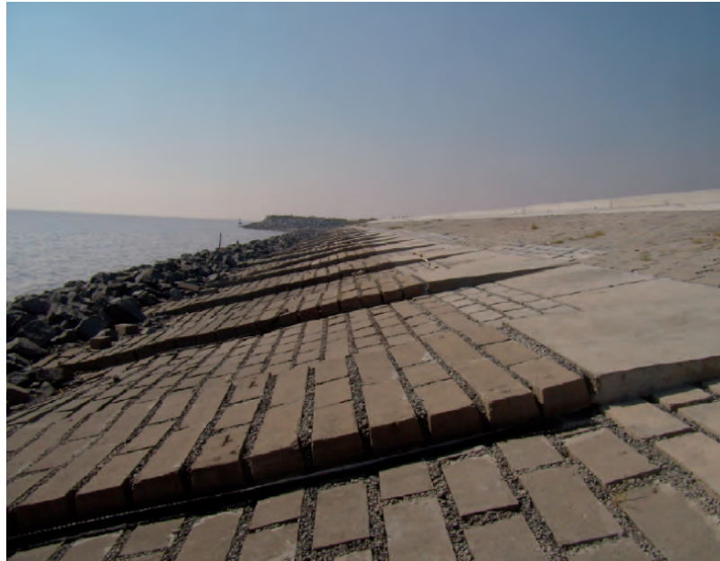
Fig. 16. Protección de la ribera en el puerto de Buenos Aires, con mantas superpuestas.
