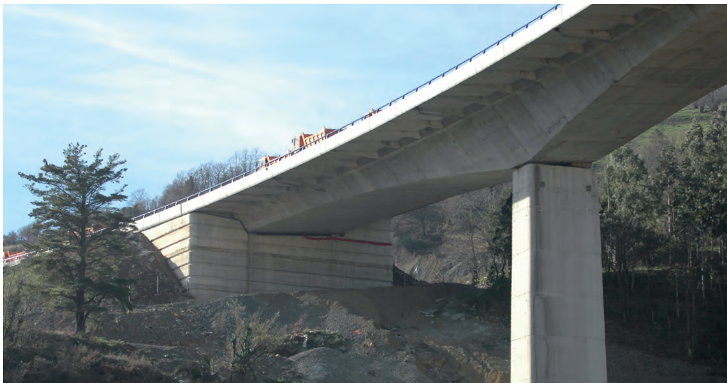
Fig. 8. Vista del estribo E2, donde se pueden apreciar los rehundidos.
