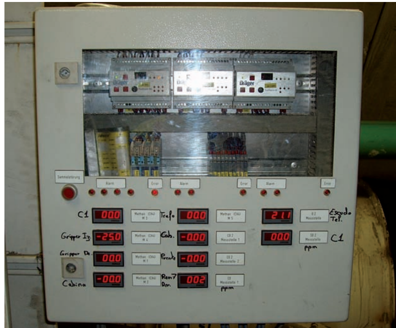
Fig. 15. Panel de control de gases instalado en el back-up.
