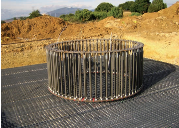
Foto N° 13. Conjunto de pernos/Picture 13. Bolt assembly.
