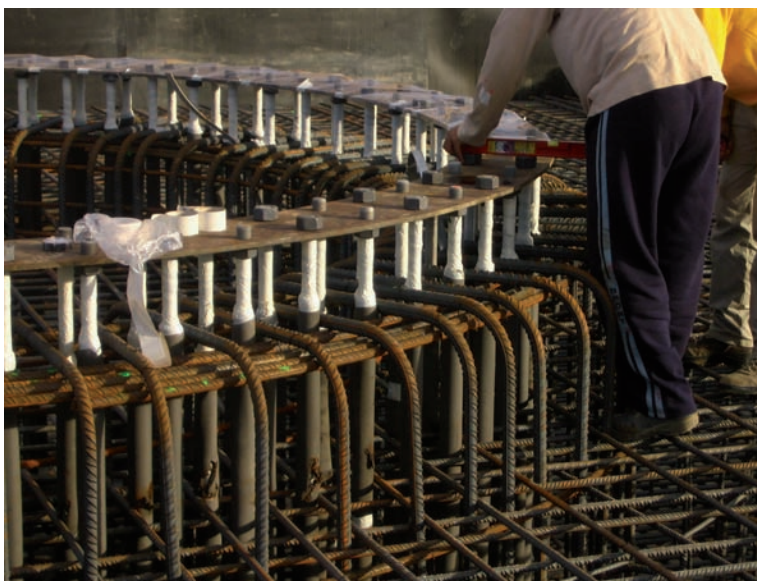
Foto 15. Pernos y armadura sobre el pedestal/ Picture 15. Bolts and framework on the pedestal.
