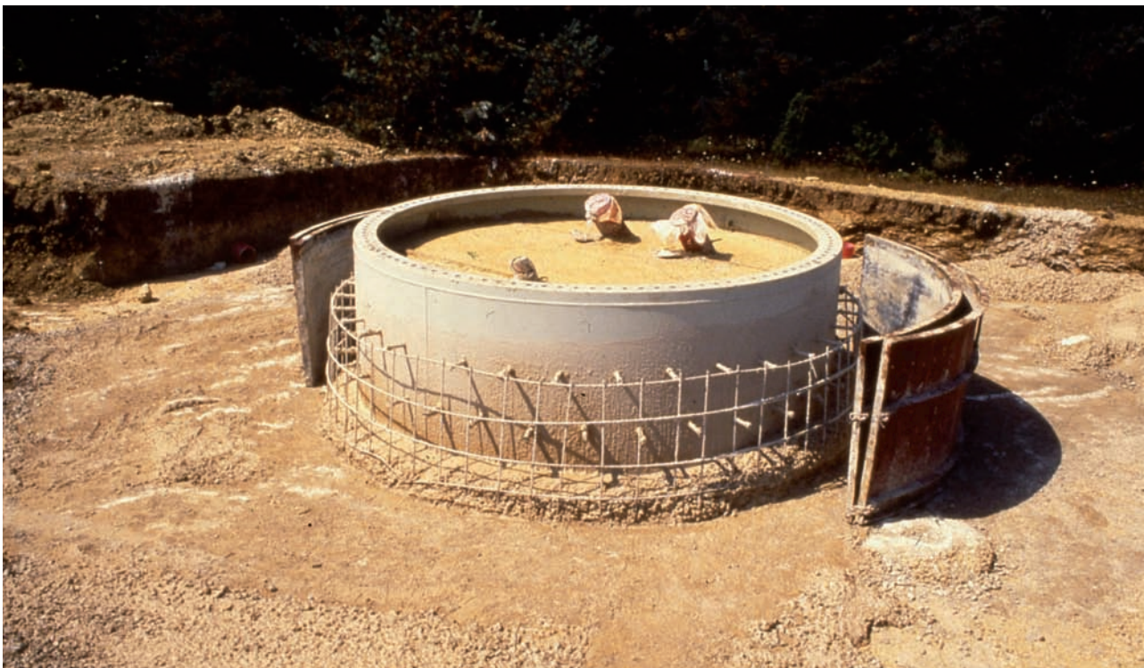
Foto Nº 12. Preparación de la franja de hormigón exterior/Picture 12. Preparing the outer concrete strip.
