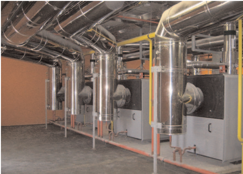
Fig. 20. Calderas de producción de agua caliente, CEN.
