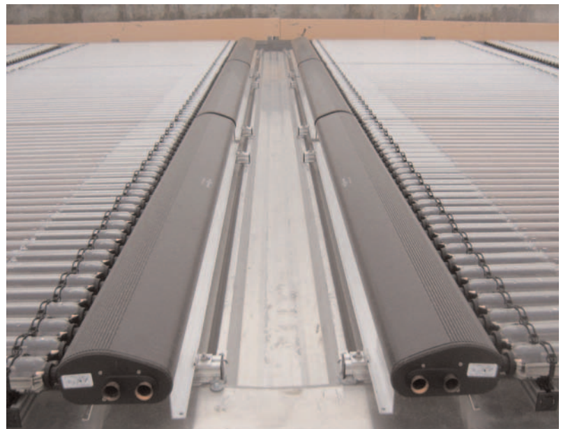
Fig. 21. Paneles solares de vacío para la producción de ACS, CEN.
