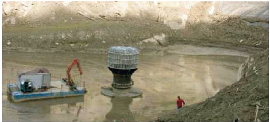
Fig. 15. La toma de agua de la presa Alesani en Francia esta obstruida por sedimentos hasta 2/3 de su altura. A la derecha, Fig. 16. Nueva torre de toma de la presa Alesani en Francia.
