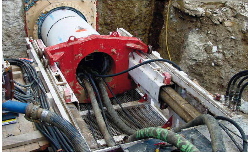
Fig. 1. Fotografías de la ejecución del desagüe de fondo en la presa de la Jarosa (Canal de Isabel II).
