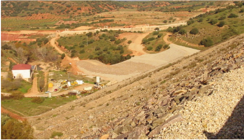
Fig. 2. Refuerzo del estribo derecho de la presa de Giribaile por presencia de filtraciones.
