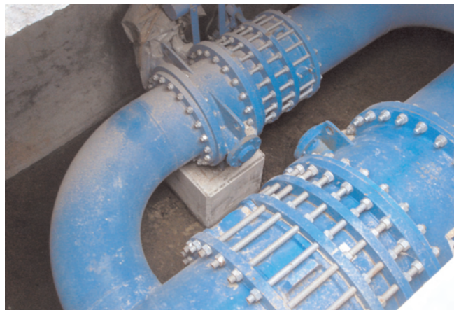
Fig. 6. Tuberías de entrada y salida/Inlet and outlet pipes to the surge tanks.
