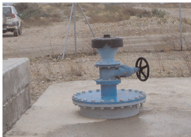
Fig. 7. Ventosa de la línea derecha junto al calderín/Vent on the right-hand line next to the surge tank
