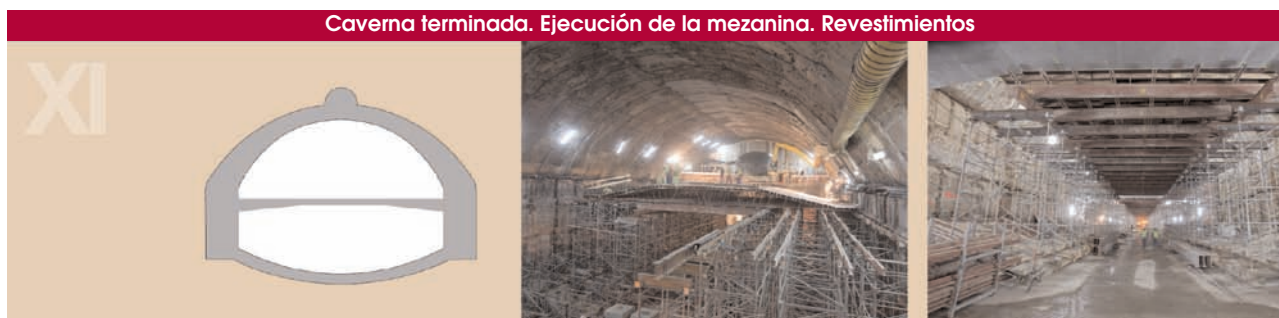
Fig. 21. Vista final de la caverna excavada con parte de la cimbra para ejecución de la mezanina.
