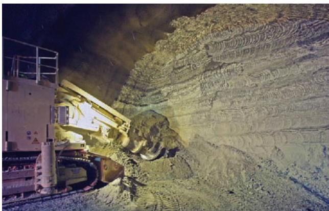
Fig.7. Precipitaciones de sales en el emboquille de El Regajal. A la derecha, fig. 8. Rozadora en el interior del Túnel de El Regajal.
