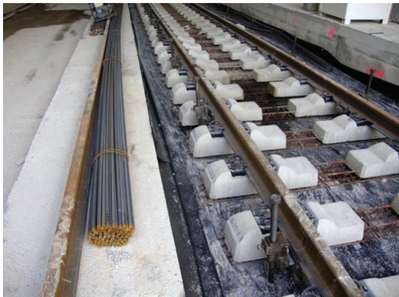
Foto 6. Traviesas bibloque de la vía en placa, previo al hormigonado de la losa.
