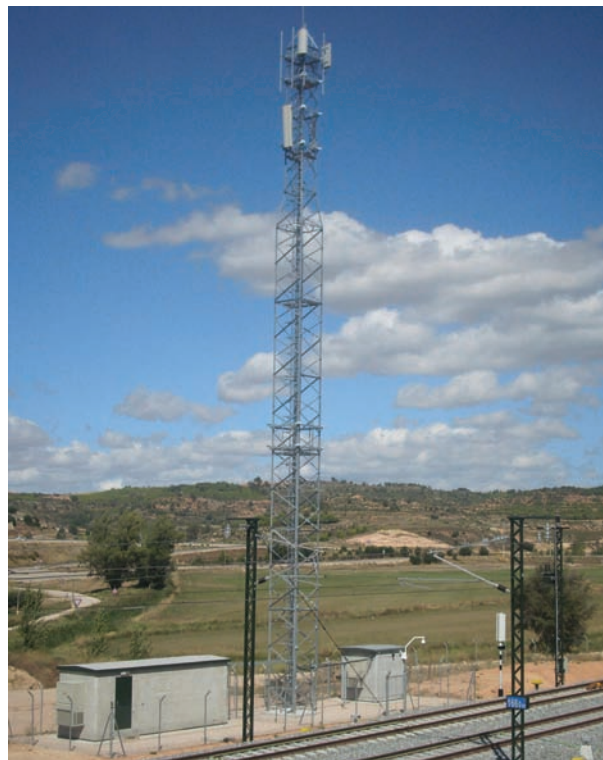
Fig. 22. BSC (Base Station Controller - Controlador de Estaciones Base).
