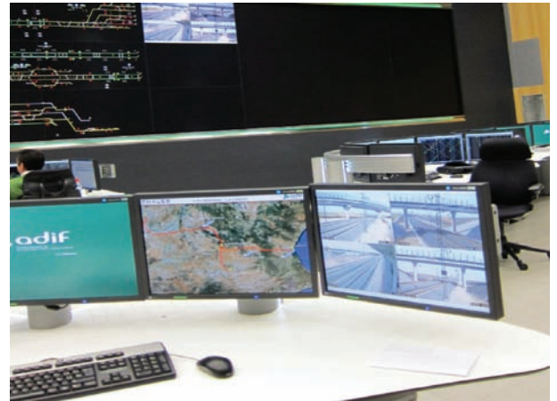
Fig. 2. Cámaras de Seguridad en VideoWall.
