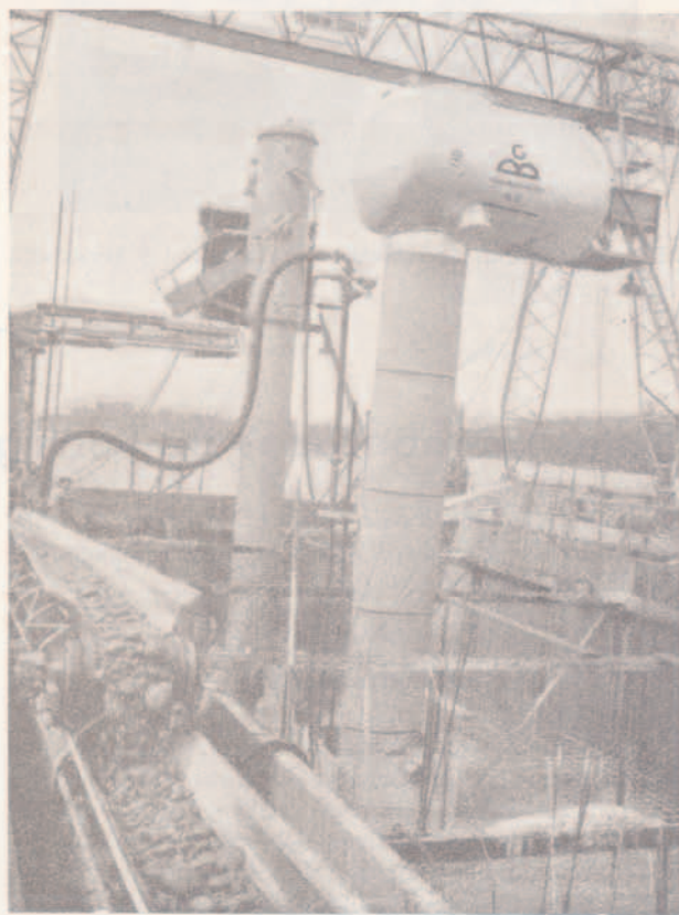
Fig. 4.ª — Esclusas para material y personal. Al fondo, la de material; en primer término, la de personal.
