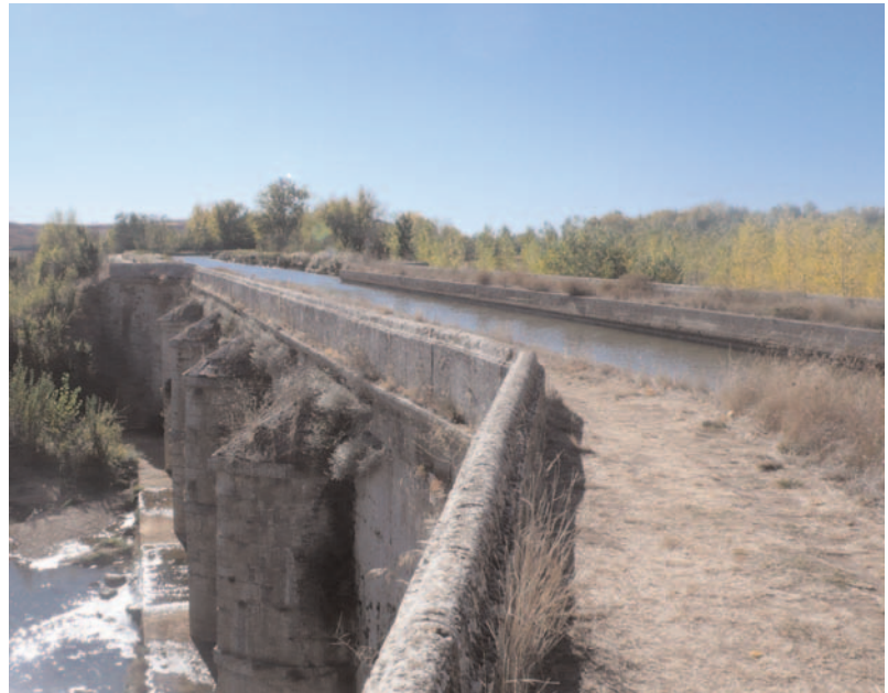
"Acueducto de Abñedes en el Canal de Castilla s/ el río Valdiva, con problemas hoy de conservación". Foto Carlos Nárdiz.
