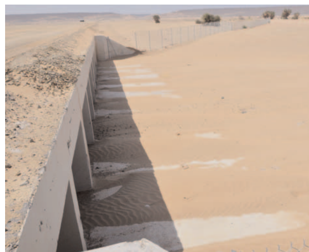
Fig. 10. Flujo de arena que discurre a través del lado sotavento de un marco de drenaje, aterrándolo parcialmente, en la zona de Rabigh del ferrocarril Haramain. Fotografía de los autores/Leeward side of a culvert near Rabigh, with sand crossing and encroaching on the boxes. Photograph taken by the authors.
