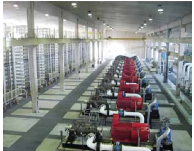
Fig. 3. Planta desaladora San Pedro del Pinatar 2
