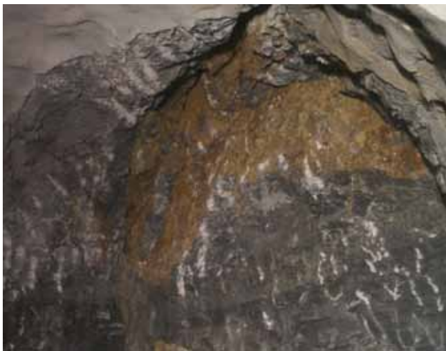
Fig. 15. Alteración de fracturas J2
