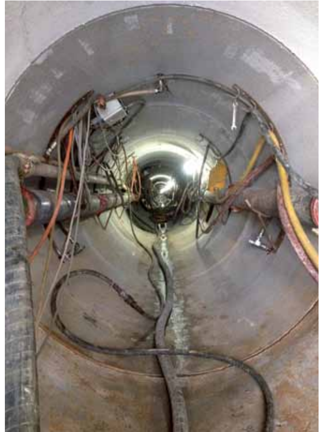
Fig. 4. Foto del interior del túnel que muestra cajas e inyectores de bentonita (BALCE)
