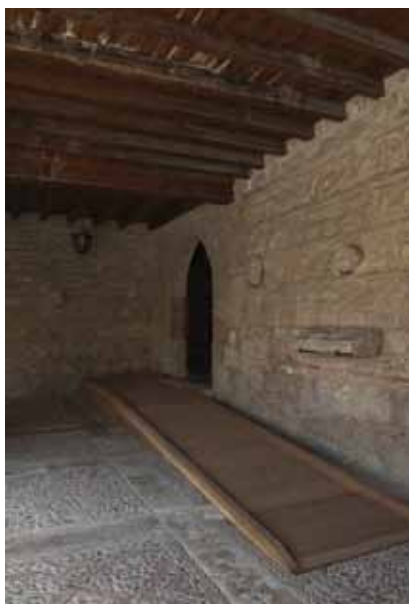
Rampas de acceso
