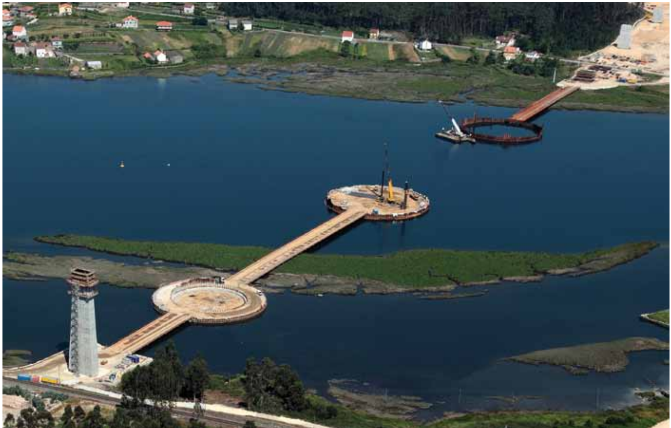
Fig. 3a. Vista aérea de los recintos de las pilas P-5, P-6 y P-7
