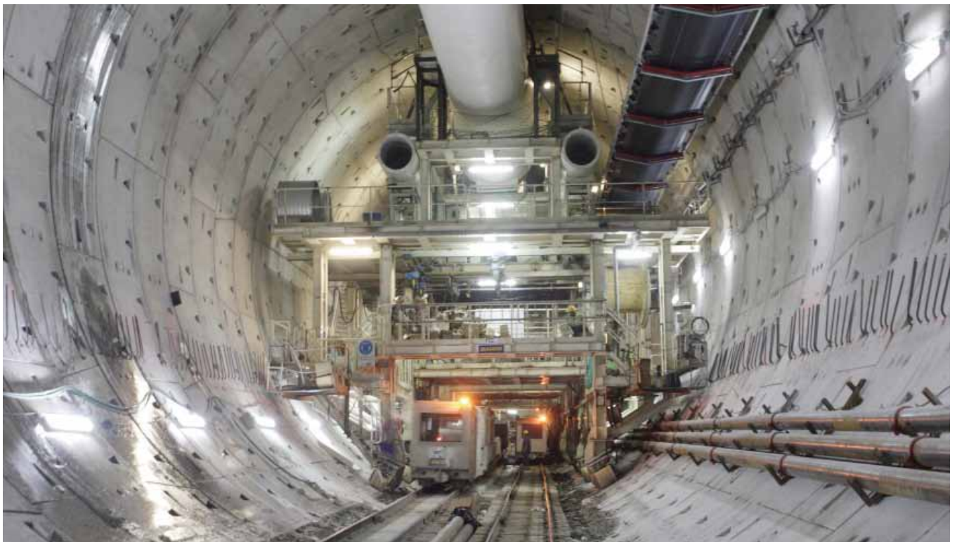
Fig. 1. Ejecución de un túnel a mediados del siglo XX (arriba) y a principios del XXI (abajo)
