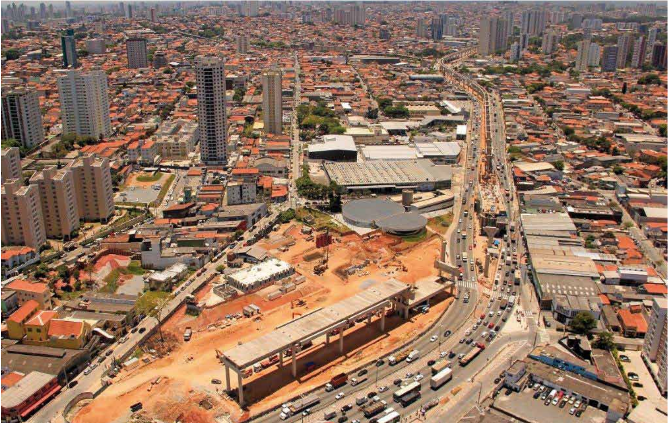
Estación de metro y autobús de Vila Prudente en São Paulo (Sacyr)
