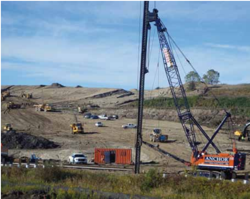
Estructura sobre Spring Creek y movimiento de tierras en el inicio oeste de la extensión
