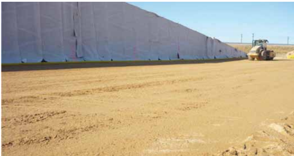
Fig. 3. Compactación de la tongada de suelo seleccionado en el trasdós sobre la que se asienta el tubo dren
