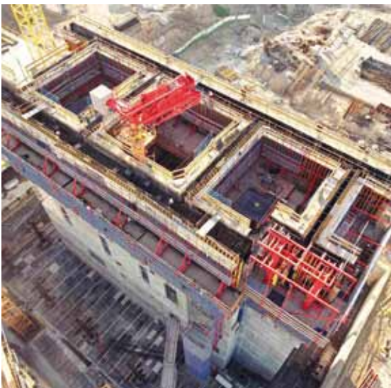
Fig. 6. Ejecución de Torre Cristal con los núcleos en avance respecto a los forjados. Combinación de sistemas Regular y Plataformas
