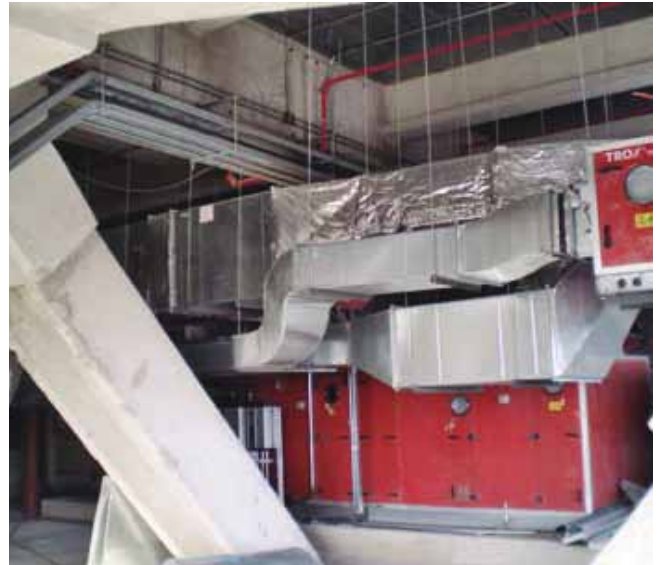
Fig. 2. Sala intermedia de climatizadores
