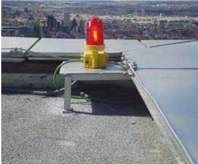
Fig. 7. Señalización de balizamiento en cubierta
