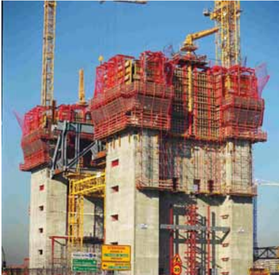
Fig. 8. Ejecución de Torre Bankia con dos núcleos en avance respecto a los forjados. Sistema Horca en el exterior
