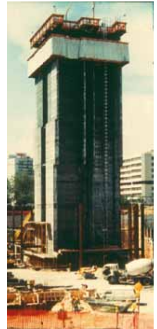
Fig. 2. Ejecución de uno de los núcleos de Puerta de Europa con encofrado deslizante
