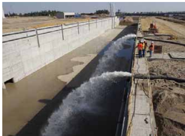
Inicio de la inundación del recinto. Octubre de 2009
