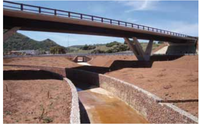
Encauzamiento de un torrente y reposición de una vía ciclista en Sant Patrici
