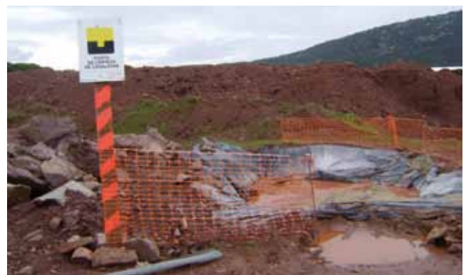
Punto de limpieza de canaletas
