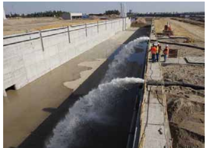
Inicio de la inundación del recinto. Octubre de 2009
