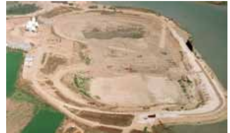
Recinto achicado y reinicio de los trabajos de excavación del recinto seco
