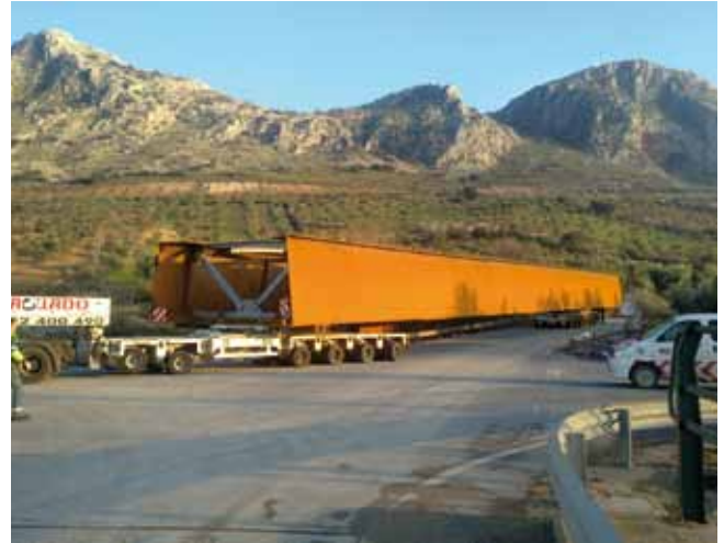
Figs. 14a y 14b. Fabricación en taller y transporte a obra de dovelas metálicas del tablero
