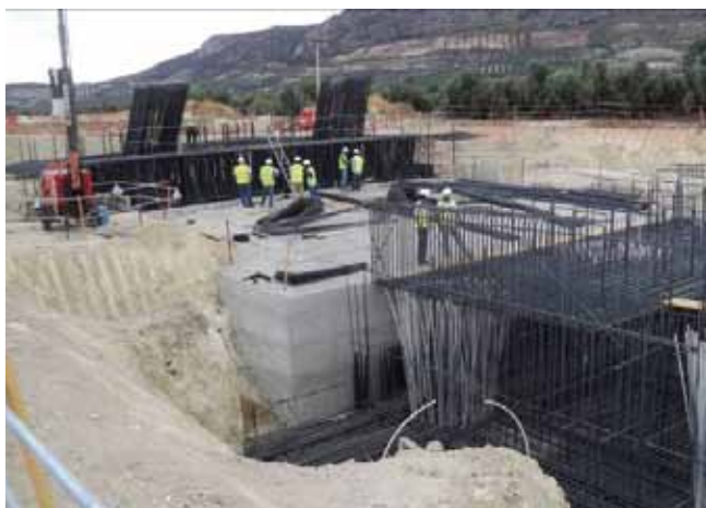
Figs. 9a y 9b. Ejecución por fases del encofrado de la Pila Central del viaducto
